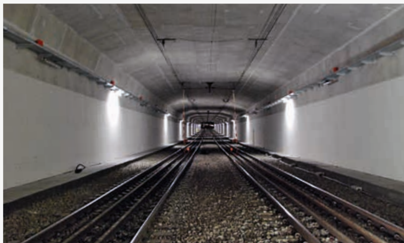
Protection incendie d'un tunnel avec des panneaux coupe-feu
